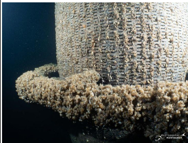
Bilder: Quaggamuschelbefall an einem Ansaugkorb vor einer Entnahmeleitung (Fotos: Pascal Montagner).
