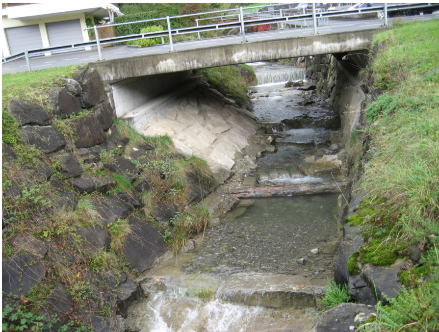
Abbildung 6: Kolke an Schwellen und im Übergang von der Sohle zur Ufersicherung am Maienbach (im Bereich der Kantonstrassenbrücke Brünigstrasse).
