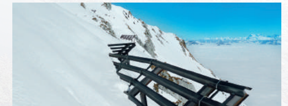
Lawinenanrissverbau mit Stahlschneebrücken
