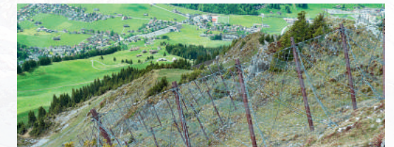
Lawinenanrissverbau mit Schneenetzen
