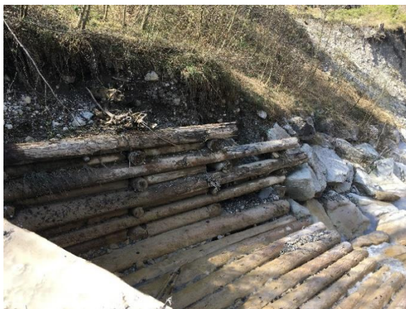
Abbildung 2: Beschädigtes Seitenleitwerk/ Holzkasten unterhalb der Furt Rütimatt
